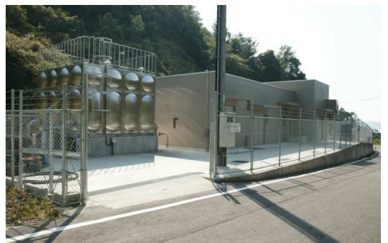
龍ヶ岳中継ポンプ場
