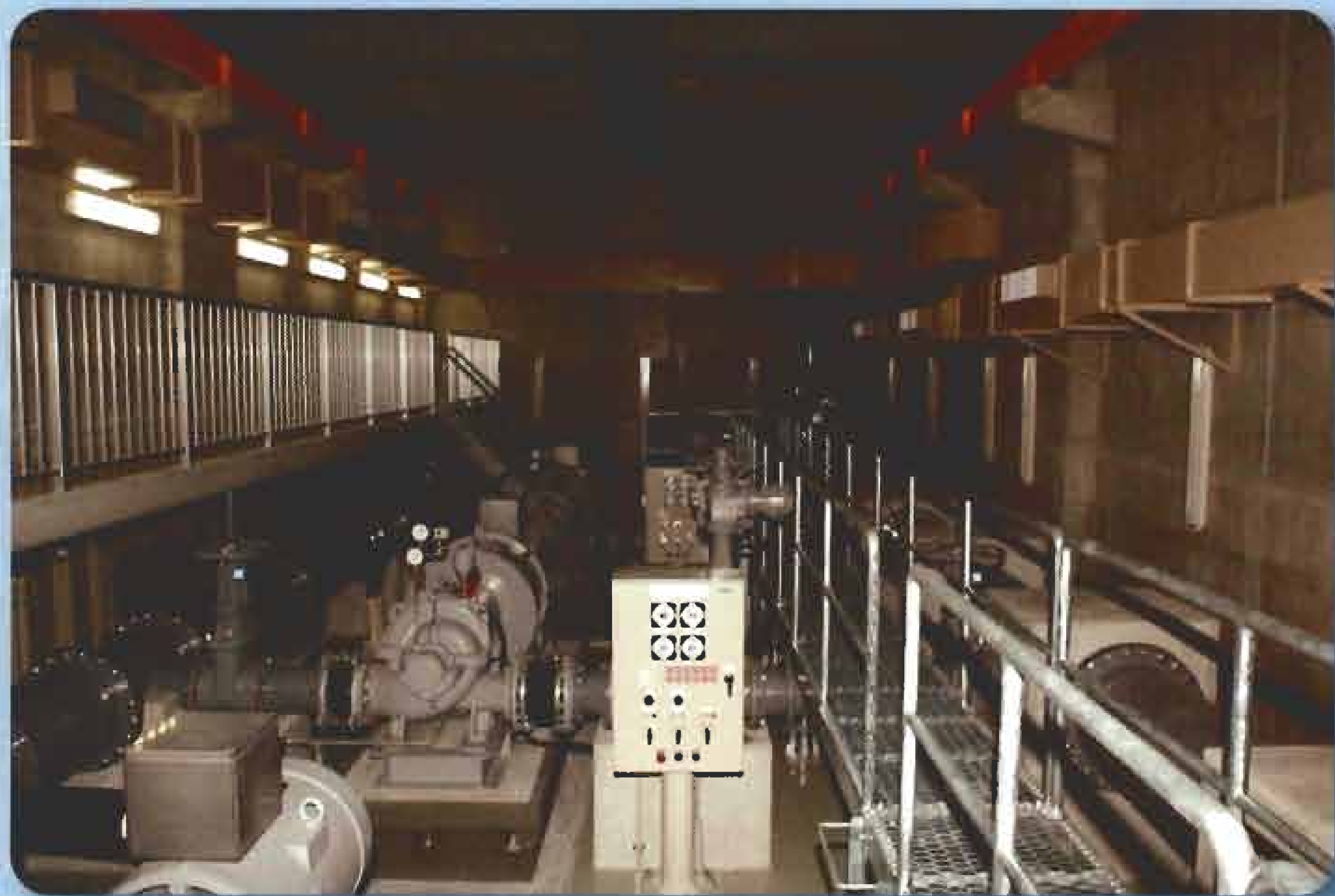
送水ポンプ室
