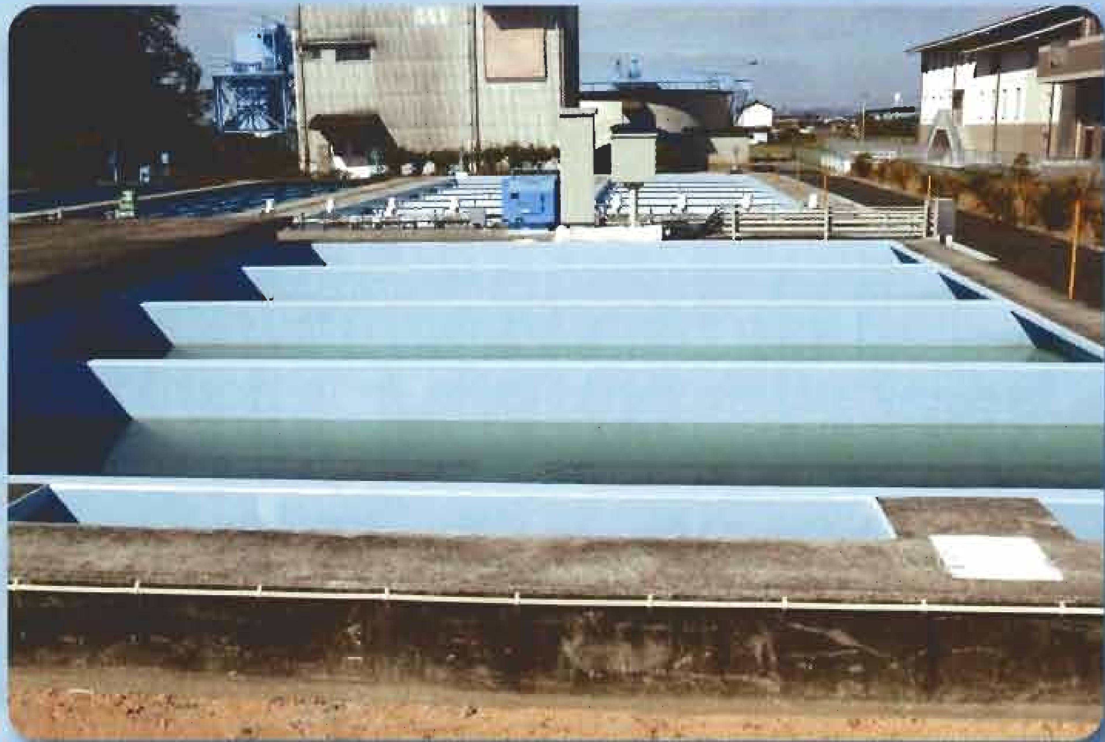
フロック形成池・沈殿池
