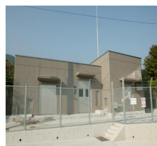
倉岳加圧ポンプ場
