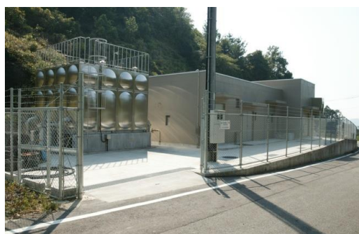
龍ヶ岳中継ポンプ場
