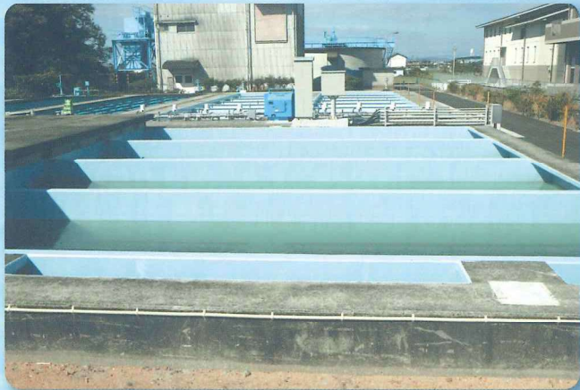
フロック形成池・沈殿池
