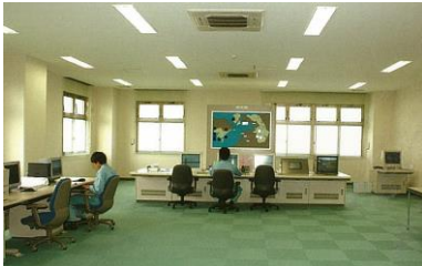
八代浄水場 （中央監視室）
