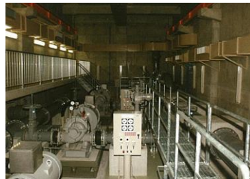
八代浄水場（送水ポンプ室）
