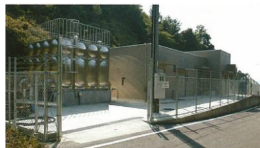
龍ヶ岳中継ポンプ場 （第4接合槽）
