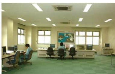
八代浄水場 （中央監視室）
