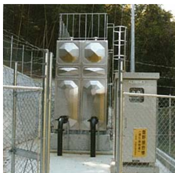
豊野接合槽 （第5接合槽）
