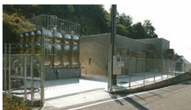
龍ヶ岳中継ポンプ場 （第4接合槽）
