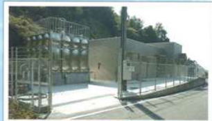
9 龍ヶ岳中継ポンプ場(第4接合槽)
